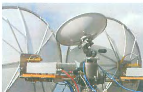
写真3 方位設定のためのBSアンテナ
